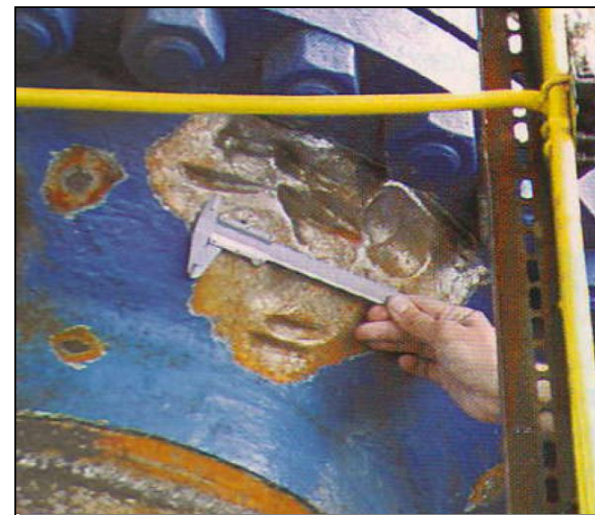
Выборка металла в зоне выявленных трещин литейного происхождения
