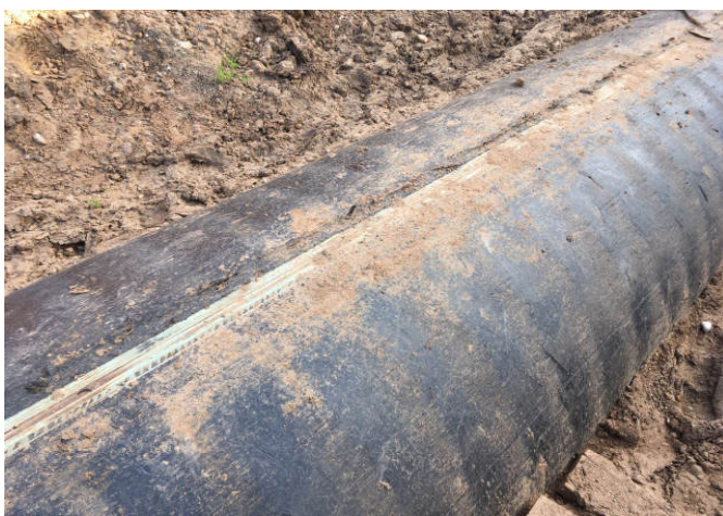
Повреждение ЗП в зоне задира (1.14).
