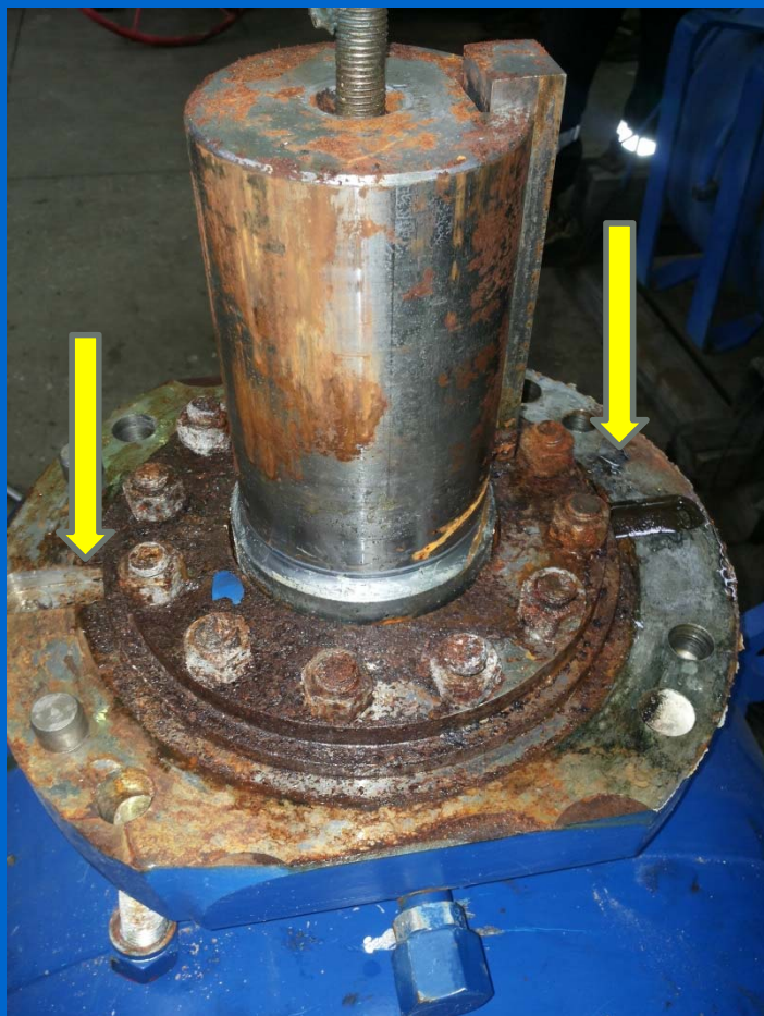
Отсутствует эластичное уплотнение. Нарушение п.7.3.1.15 СТО Газпром 2-4.1- 212-2008
