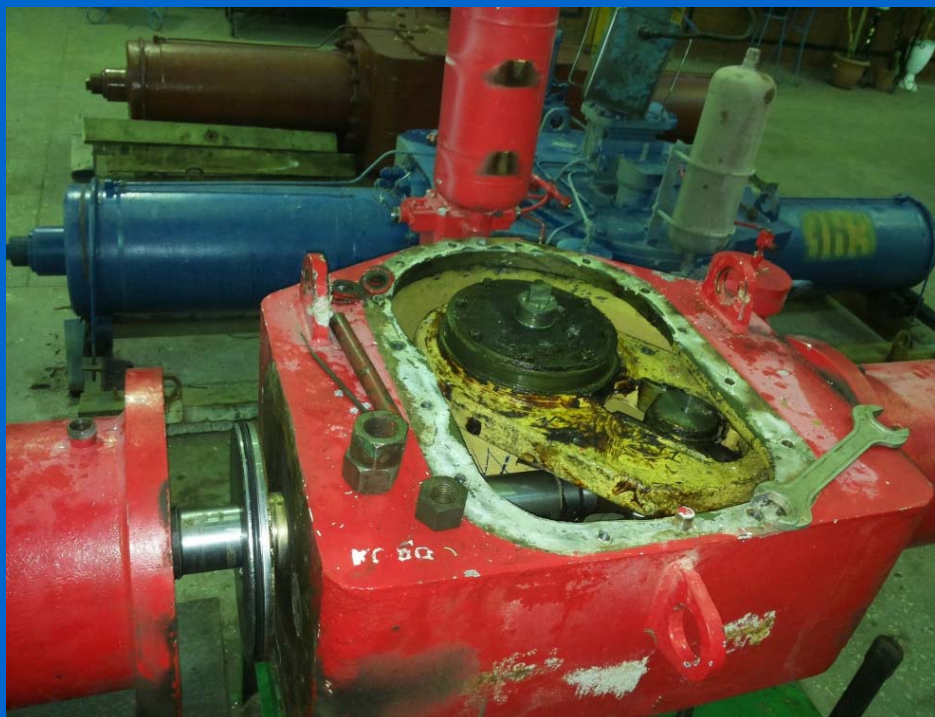
Отсутствие технологических лючков
