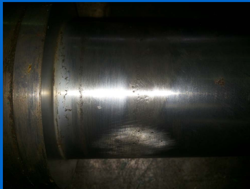
Коррозия шпинделя Ду 700мм 2 шт.
