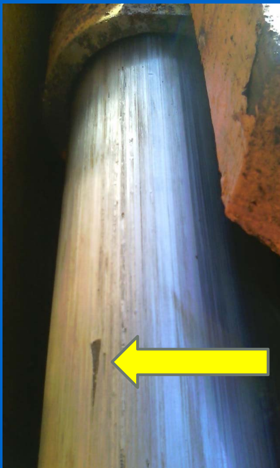
Подклинивание на штоке направляющей Ду 1400мм 2 шт.
