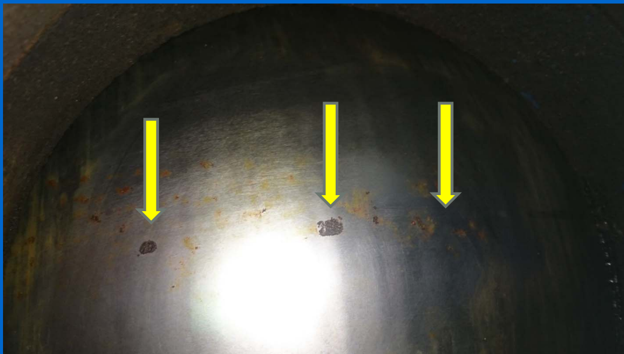
Коррозия шарового затвора Ду 300 2 шт.
