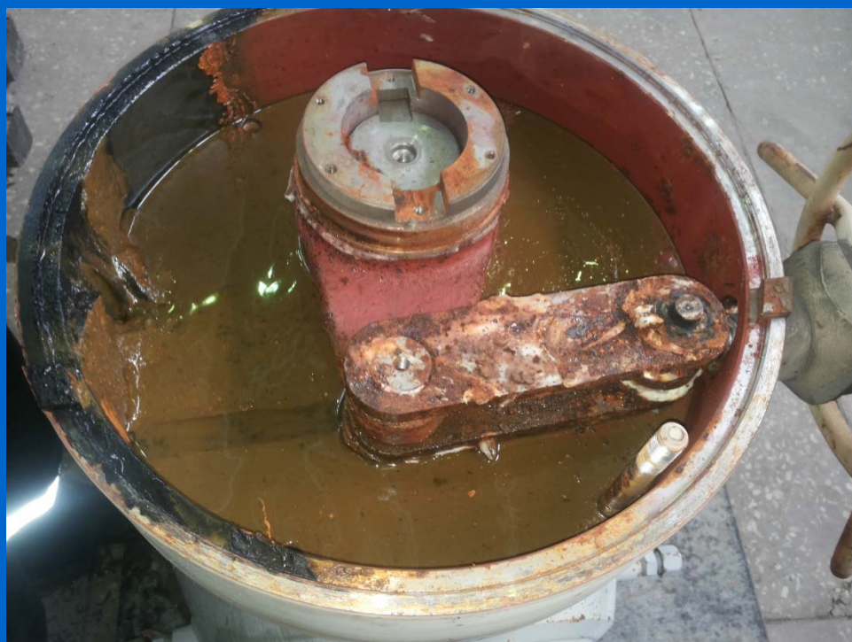
Отсутствие герметичности корпуса привода 14шт
