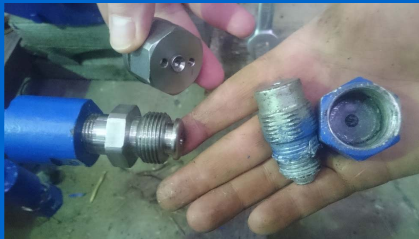
Штуцер набивочный травмоопасный. Выполнена замена 80%.
