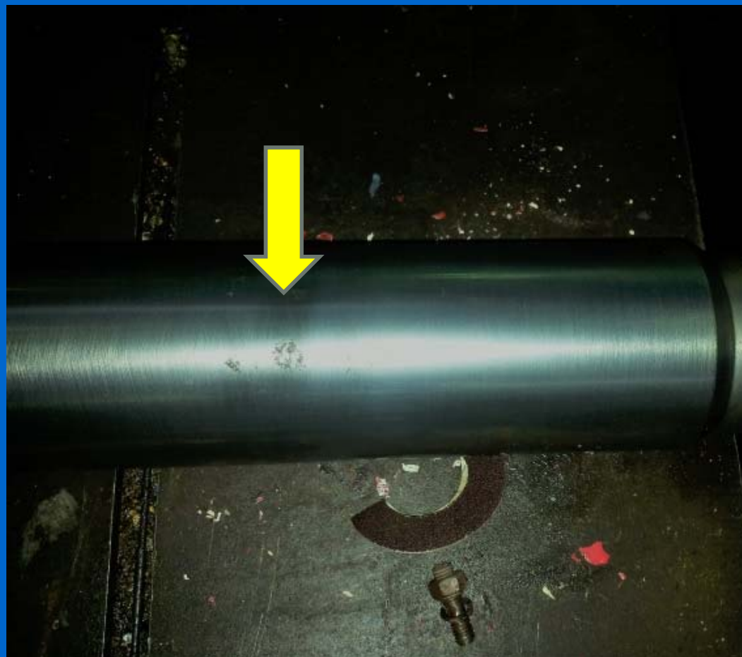
Коррозия штоков поршней. Ремонт 3 шт. Ду 1400.
