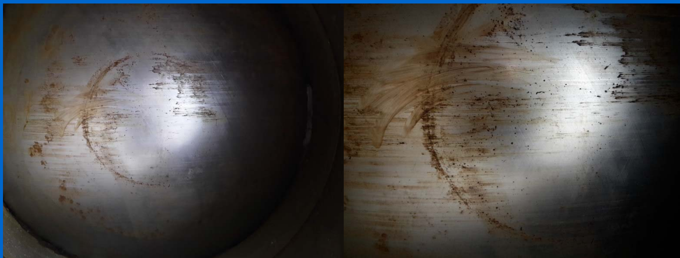
Коррозия затвора 7 шт.
