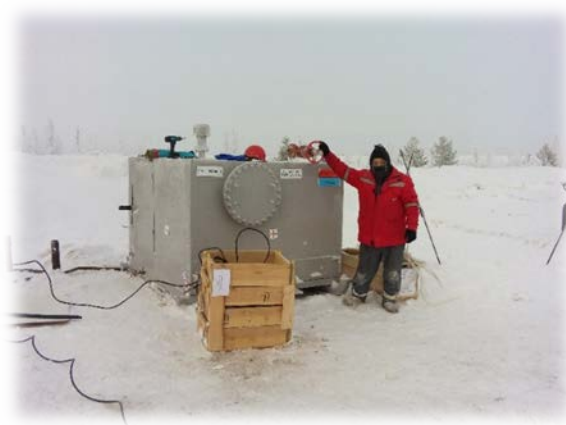
Блок дозирования метанола
