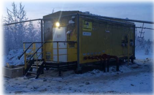
АГЗУ (Автоматическая групповая замерная установка)
