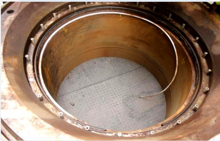
Механические повреждения уплотнений
