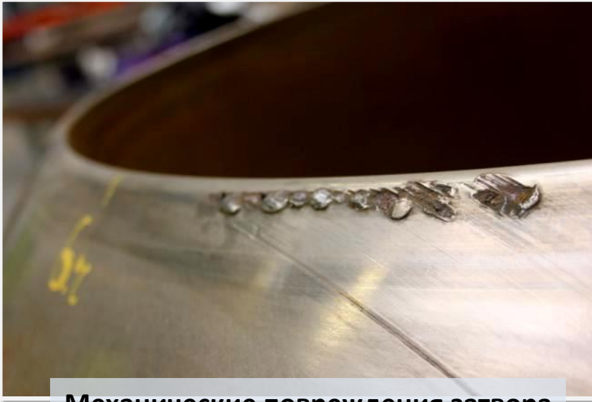
Механические повреждения затвора
