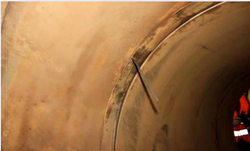
Нарушения при строительно-монтажных работах
