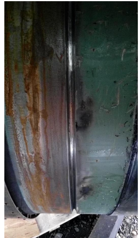
Внешний вид заполняющего слоя сварного шва
