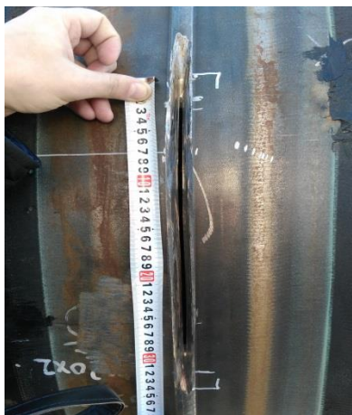
Внешний вид выборки дефектного участка сварного шва
