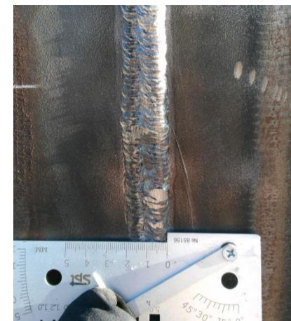
Внешний вид облицовочного слоя сварного шва
