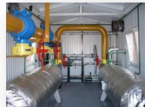
Модуль редуцирования и замера расхода газа
