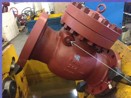
Отсутствие демпфирующего устройства и указателя положения затвора
