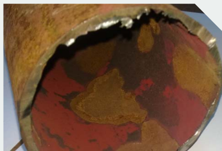
Язвенная коррозия металла трубопровода «Конденсат водяного пара» марка стали 09Г2С Ду 89х6 Установка УПС
