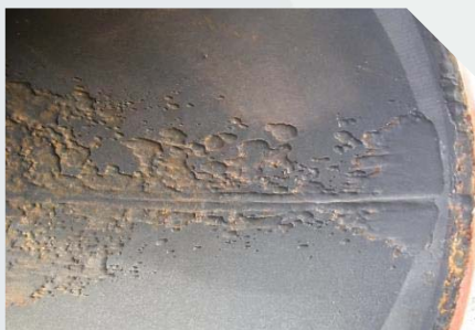
Коррозионно-эрозионный износ трансферного трубопровода Печи П-1 материал сталь 15Х5М Ду 350х16 установка ЭЛОУ-АВТ-2
