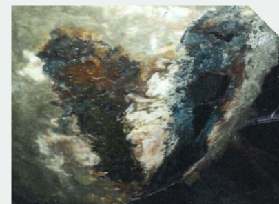
Коррозия под напряжение на трубопроводе «Хвостовых газов» ст 20 Ду 273х8 установка ГОДТ
