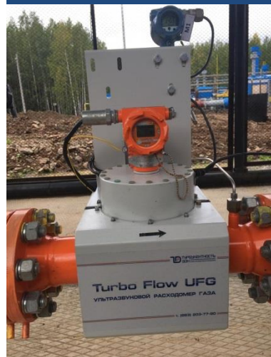
ГРС г. Красноуральск
